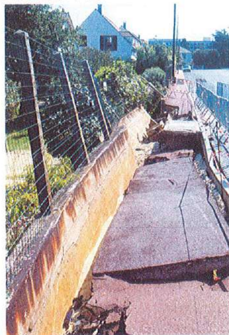
A l'angle des rues Lionel Terray et des Jeunes Marquises, mur de soutènement et trottoir emportés par les eaux. Spectaculaire !
